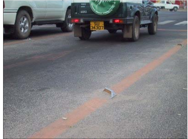
Fig. 11 Severe road stud. Dar es Salaam
